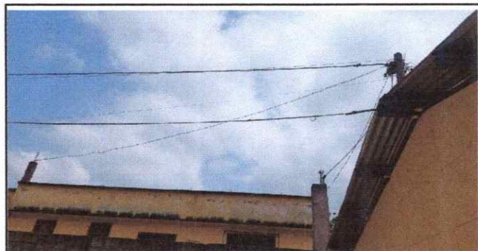
Foto 6: Ubicación del forma segura del sistema eléctrico del centro educativo
